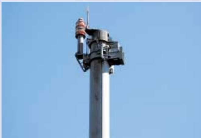
㉘ 航空障害灯 Aeronautical Obstruction Light
